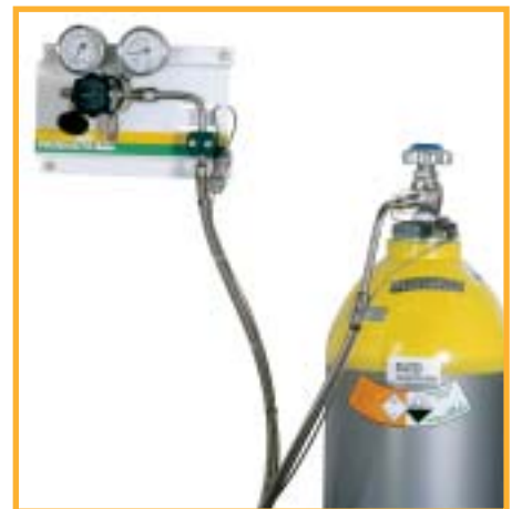
Gasflasche angeschlossen an einen fest installierten Druckminderer
