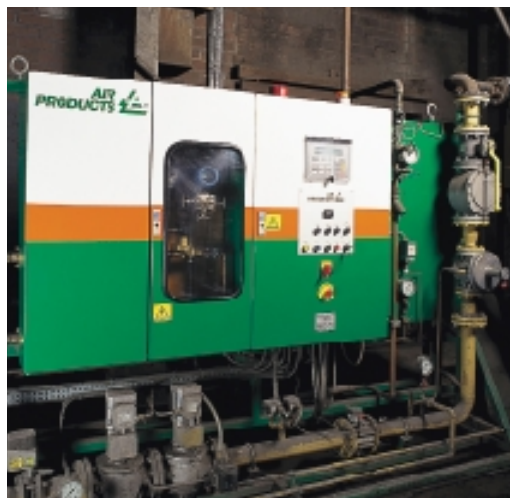
Sauerstoff- und Erdgasregelstrecke
